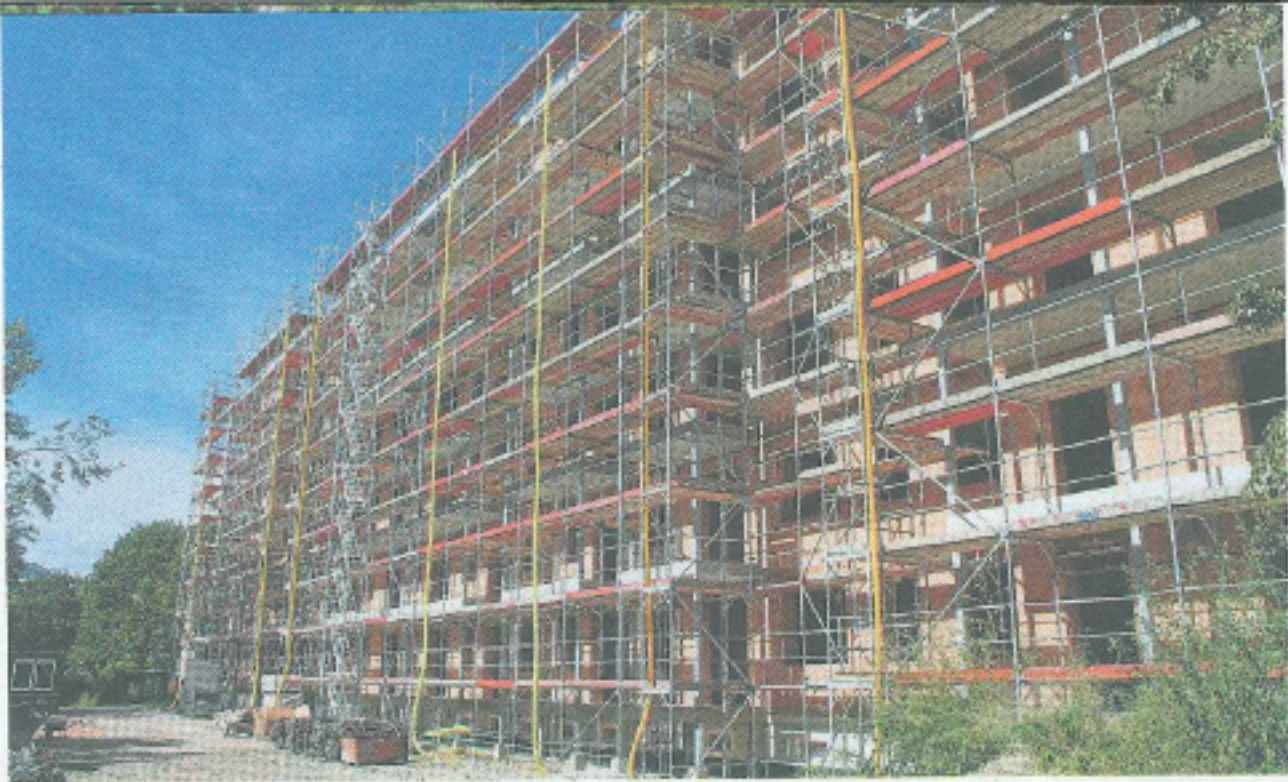
Der Bau wird aus roten Poroton-Ziegeln errichtet. Dadurch kann auf eine teure Fassadendämmung verzichtet werden. Foto: BA
